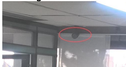
FIGURA 8 Cámara de vigilancia área de informática
